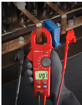
BENNING CM 8, Leistungsmessung am Leistungsteil eines DC/ AC-Umrichters
