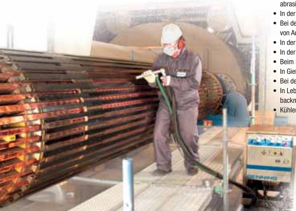
Trockeneisreinigung eines Induktors vor Ort
