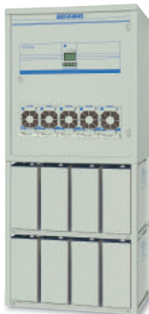
Proudový zdroj s bateriemi 48 V – 280 A (15 kW)
