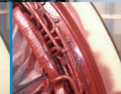
Abb. 3: Hier ist der Bereich neu lackiert
