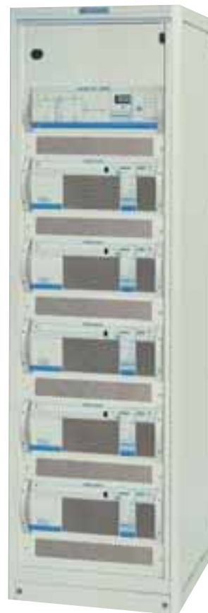
Рис. 5: Инверторная установка 5 x 2,5 кВА с EUE
