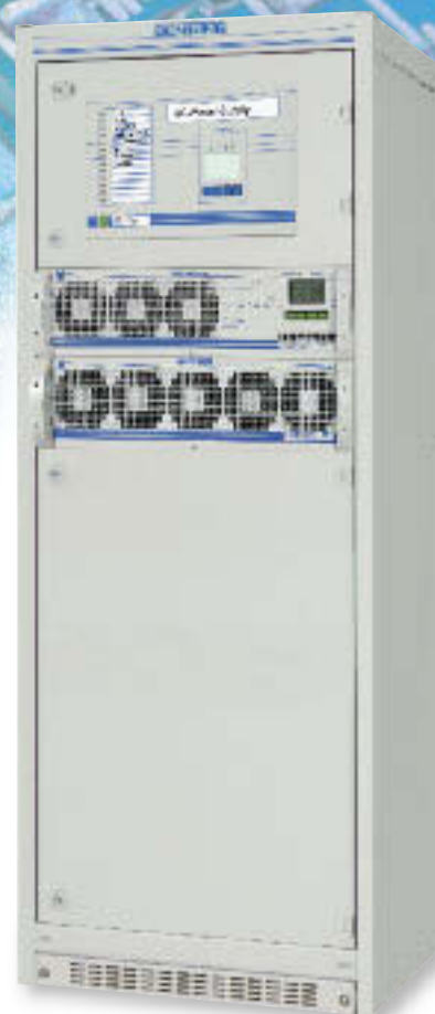
Fig. 7: La cabine onduleur avec 8 modules, un contacteur statique et un by-pass manuel pour une puissance totale de sortie AC 12 kVA
