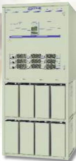
Armario de pared con baterías
